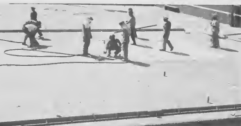
EMPLEADONAN di Lago asigná na e proyecto di Lago Sport Park ta munistrá ponenda e latanan na e altura deseá y cualnan ta wordé usa despues pa nivelá e concreto segun e ta wordé bashá.
